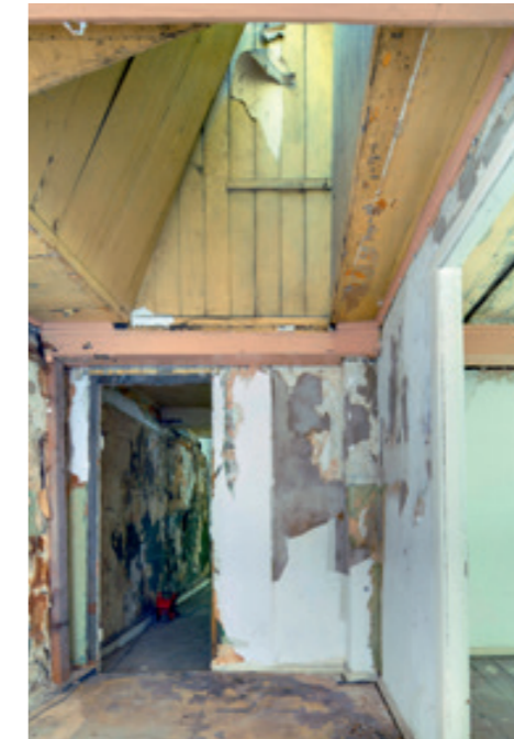
Raum im Obergeschoss des Rückflügels, Juli 2017. Die Räume an der Südseite waren nur über einen Schacht mit Tageslicht versorgt.
