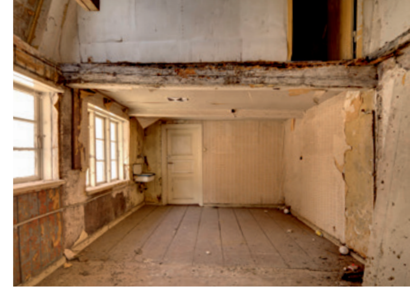
2. Seiten- bzw. Tonnendachflügel, Obergeschoss vor Beginn der Sanierung, Mai 2016
