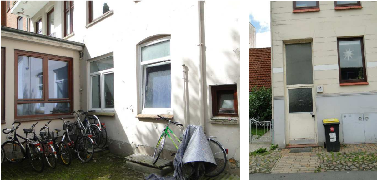
Unterschiedliche Fensterarten und -aufteilungen, eine für ein denkmalgeschütztes Haus unpassende Haustür (Ballastbrücke 10)
