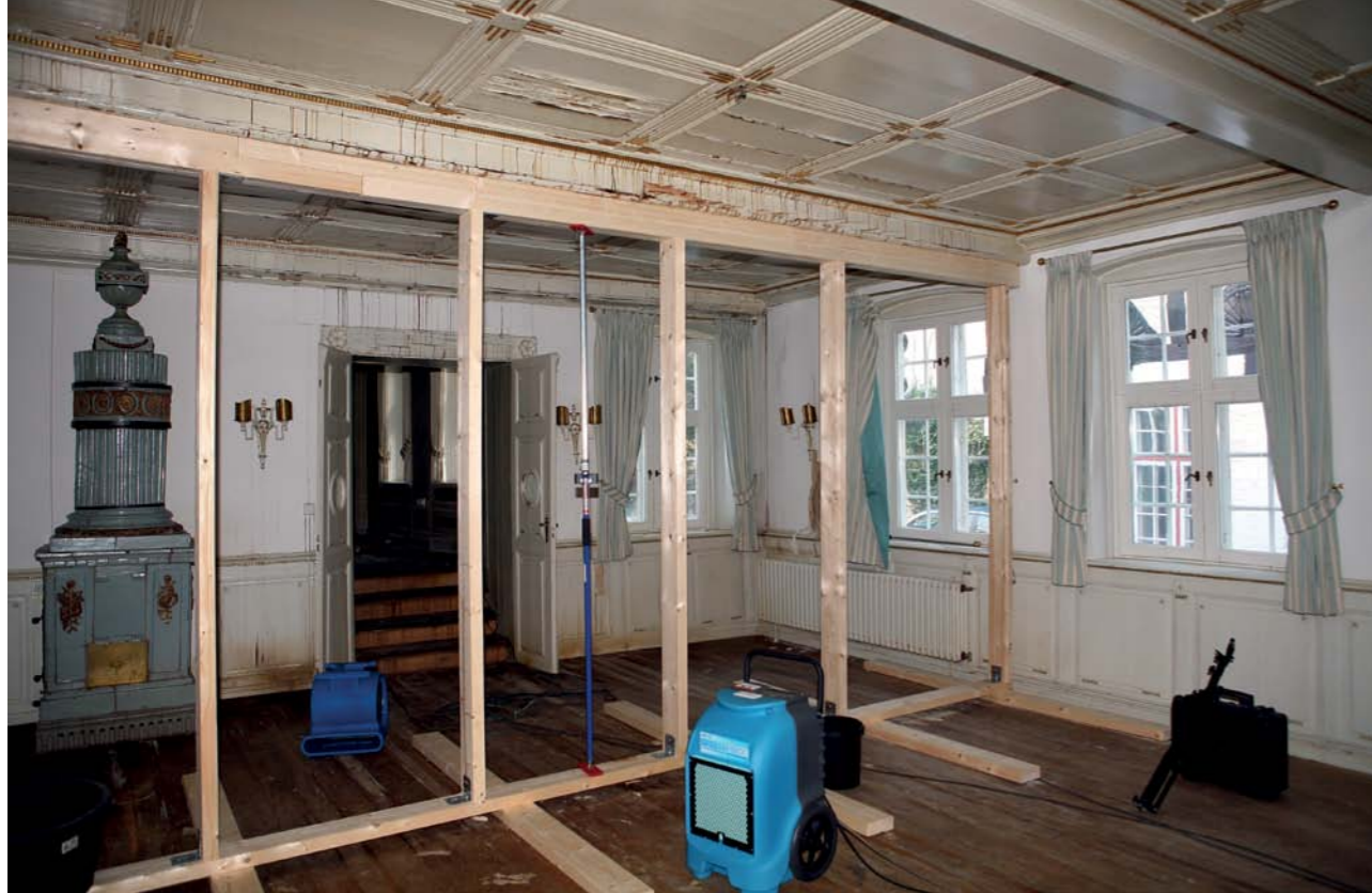
ECKENERHAUS NORDERSTRASSE 8-10 PROVISORISCHE ABSTÜTZUNG IM EMPIREZIMMER FOTO: EIKO WENZEL | STADT FLENSBURG
